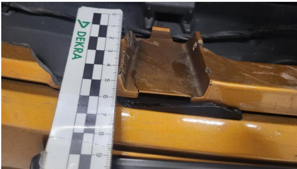
Fot. 59. Zderzak - Pęknięcie/rozerwanie 2
