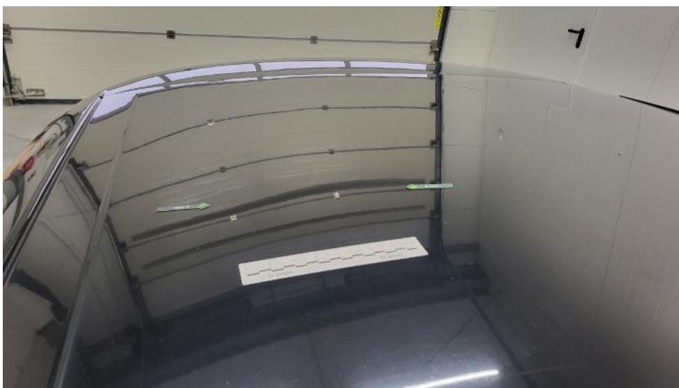
Fot. 75. Dach - Wgniecenie/odkształcenie 1
