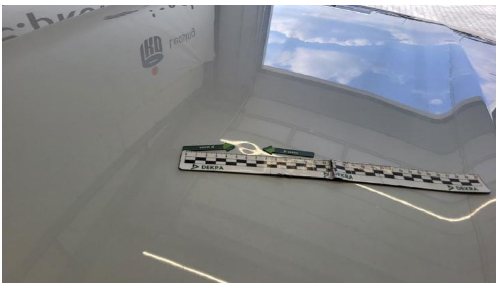
Fot. 46. Dach - Wgniecenie/odkształcenie 2
