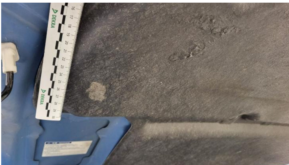
Fot. 51. Wykładzina pokrywy komory silnika - Pęknięcie/rozerwanie 1
