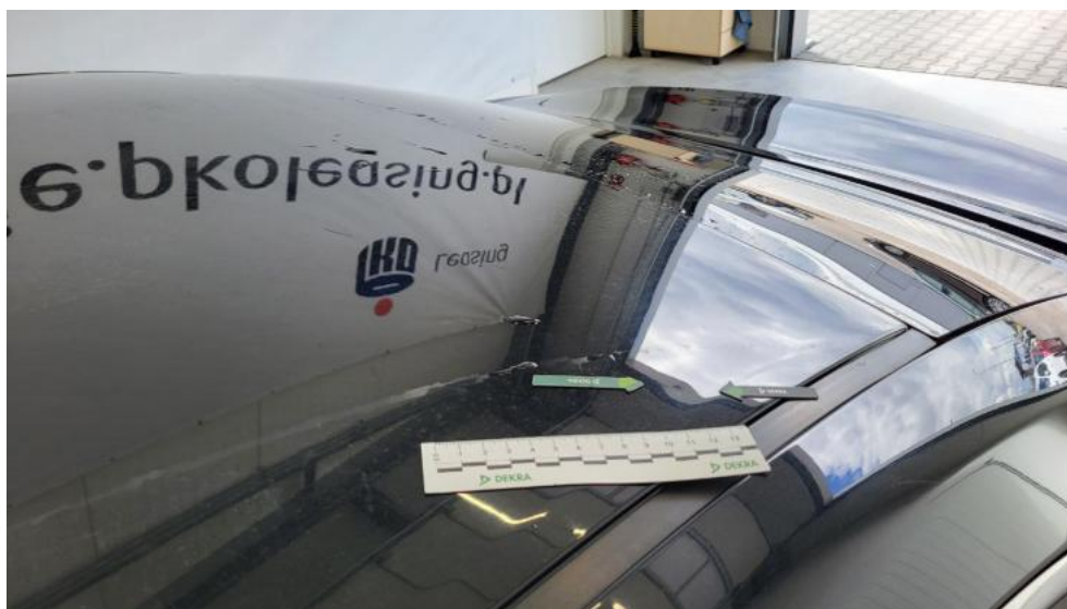
Fot. 63. Dach - Wgniecenie/odkształcenie 1
